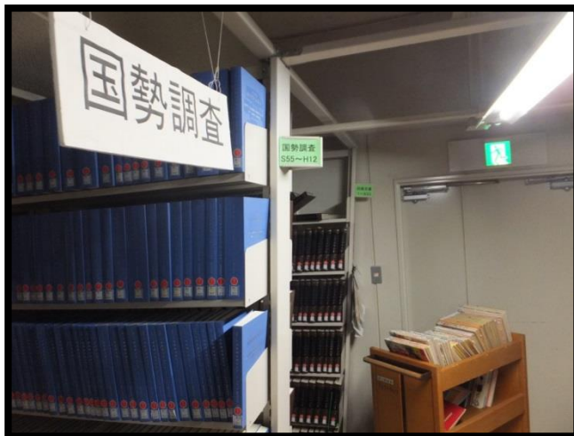
② 中2階閉架書庫 自立式書架破損 2
