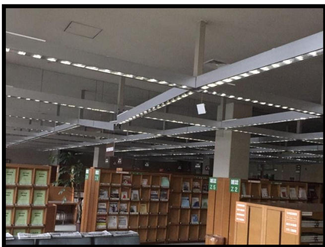
⑤ 3階閲覧室 照明落下・破損 2
